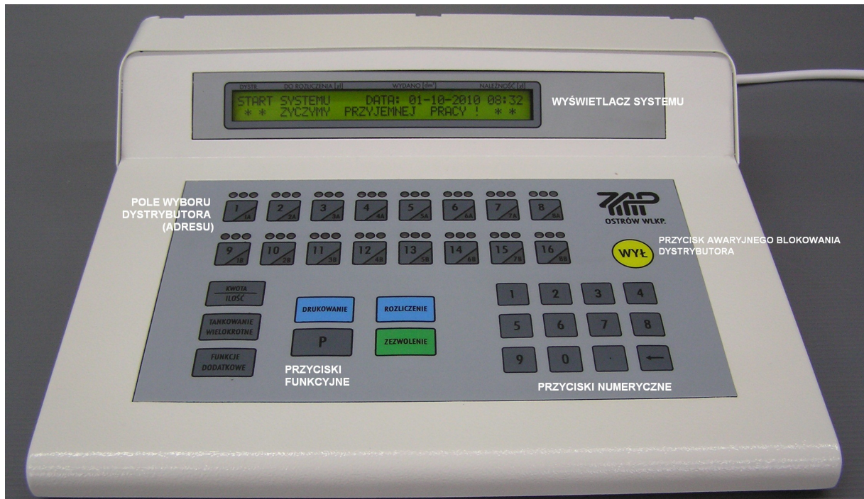
Rys. 1 – Widok pulpitu od strony operatora.
